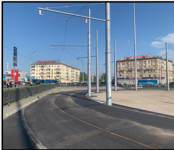
УЛУЧШЕНИЕ ИНЖЕНЕРНОЙ ИНФРАСТРУКТУРЫ
